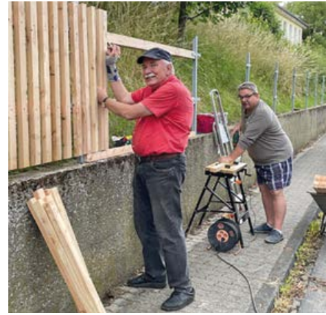
Montage des neuen Zauns »Im Beeke« durch KV-Mitglied und Ehrenamtlichen Foto: km
